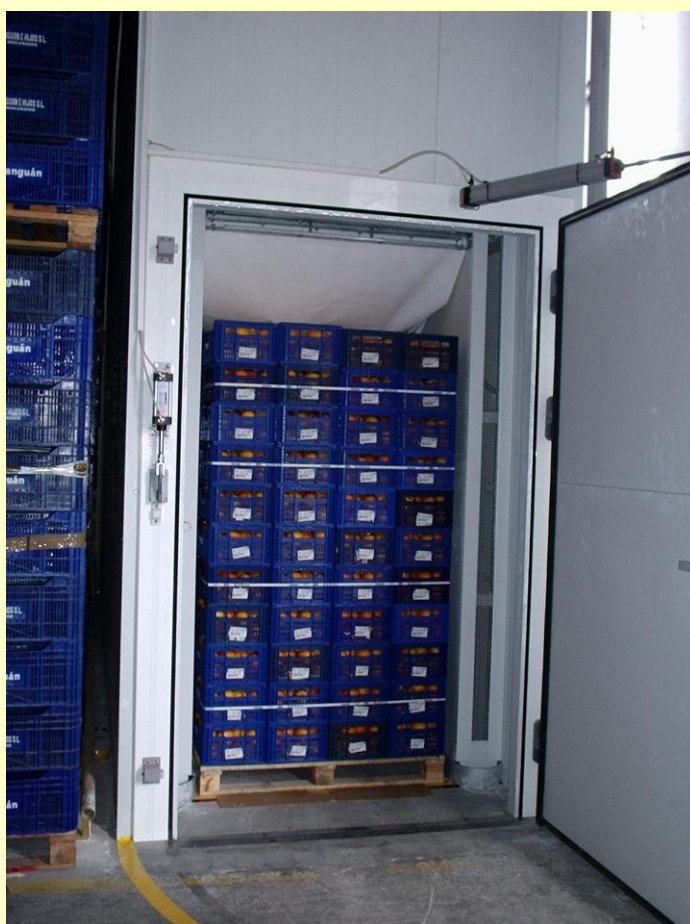
Túnel de una línea de diez palets.
